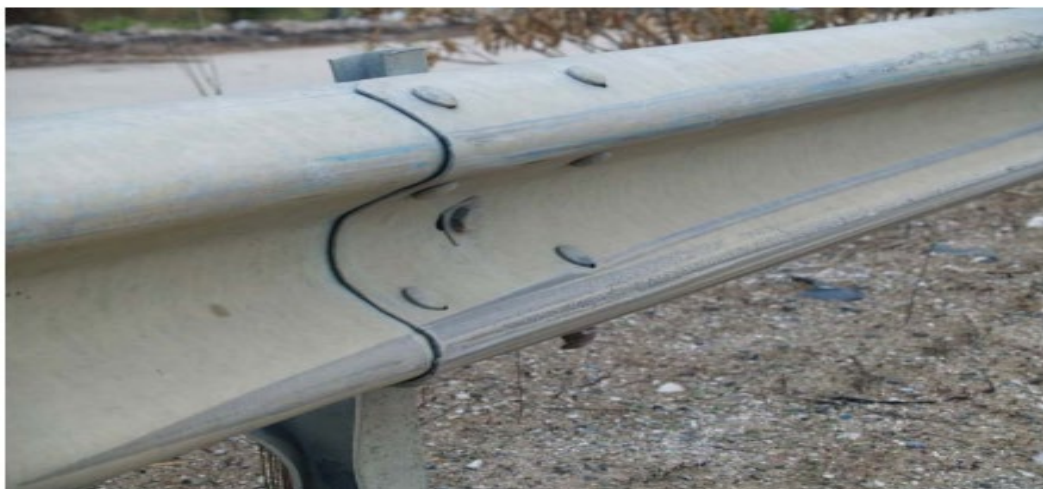
Σχήμα 24 Η σκηνή του ατυχήματος στη Χ.Θ. 34,200 της Ν.Ε.Ο. Πατρών-Πύργου, δεύτερη ομάδα ιχνών πρόσκρουσης του SUZUKI SX 4x4 στο μεταλλικό στηθαίο, ρεύμα κυκλοφορίας Πάτρα – Πύργος. Απόσταση 4,20 μέτρα από τα προηγούμενα ίχνη.
