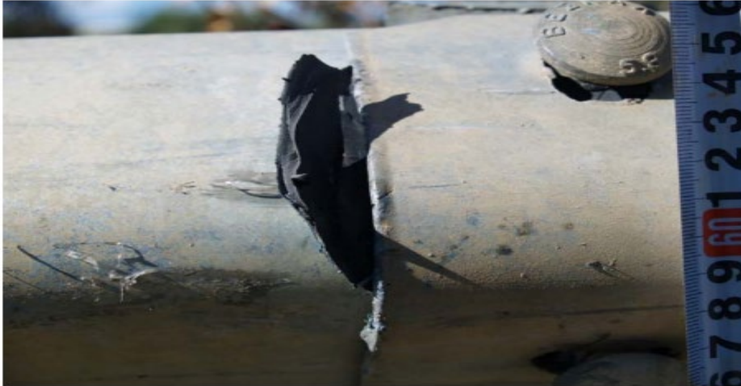
Σχήμα 77 Επαφή του οπίσθιου προφυλακτήρα με το μεταλλικό στηθαίο, ύψος στο σημείο επαφής 640 χιλ.
