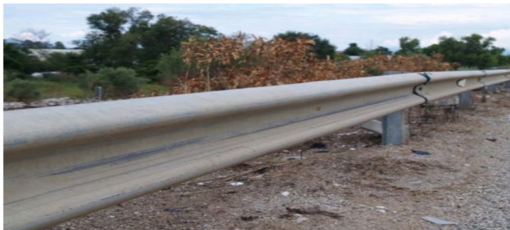
Σχήμα 25 Η σκηνή του ατυχήματος στη Χ.Θ. 34,200 της Ν.Ε.Ο. Πατρών-Πύργου, συνέχεια των ιχνών πρόσκρουσης του SUZUKI SX 4x4 στο μεταλλικό στηθαίο, ρεύμα κυκλοφορίας Πάτρα – Πύργος.
