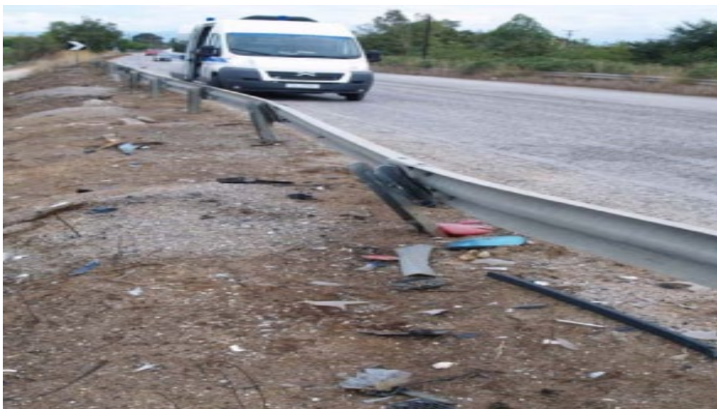
Σχήμα 33 Η σκηνή του ατυχήματος στη Χ.Θ. 34,200 της Ν.Ε.Ο. Πατρών-Πύργου, το σημείο σύγκρουσης του SUZUKI SX 4x4 με το μεταλλικό στηθαίο στο ρεύμα κυκλοφορίας Πάτρα – Πύργος.
