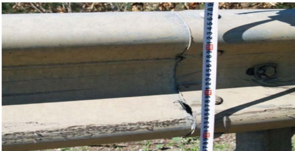
Σχήμα 75 Επαφή με το μεταλλικό στηθαίο, ύψος στο σημείο πρώτης επαφής, ύψος 350 χιλ.
