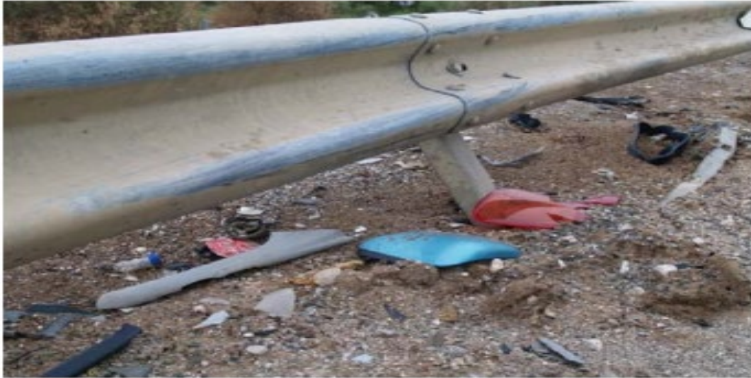
Σχήμα 30 Η σκηνή του ατυχήματος στη Χ.Θ. 34,200 της Ν.Ε.Ο. Πατρών-Πύργου, το σημείο σύγκρουσης του SUZUKI SX 4x4 με το μεταλλικό στηθαίο στο ρεύμα κυκλοφορίας Πάτρα – Πύργος.
