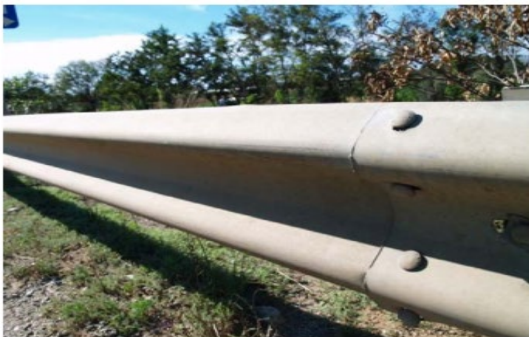
Σχήμα 23 Η σκηνή του ατυχήματος στη Χ.Θ. 34,200 της Ν.Ε.Ο. Πατρών-Πύργου, το πρώτο σημείο πρόσκρουσης του SUZUKI SX 4x4 στο μεταλλικό στηθαίο στο ρεύμα κυκλοφορίας Πάτρα – Πύργος. Απόσταση 28,50 μέτρα από τον ιστό ηλεκτροφωτισμού.
