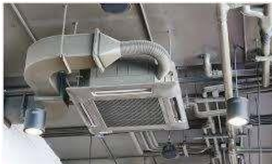
Σχήμα 2.2. Αεραγωγός και Στόμιο εκροής ενός συστήματος HVAC.
