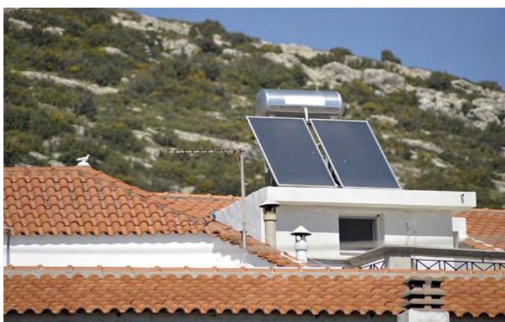
Εικόνα 2.3 Θερμικά ηλιακά συστήματα εγκατεστημένα σε οροφές κτιρίων
