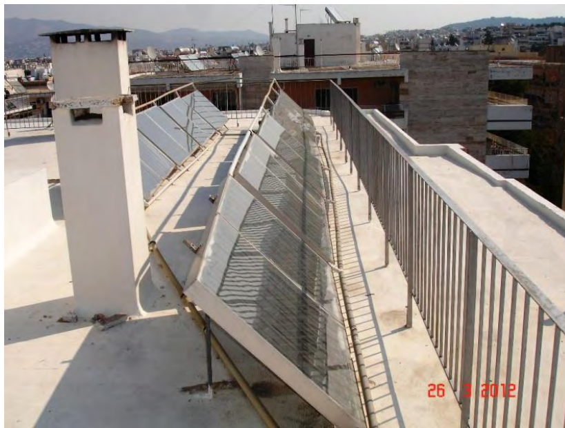
Εικόνα 2.9 Θερμικά ηλιακά συστήματα εγκατεστημένα σε οροφές κτιρίων Πηγή: (26)
