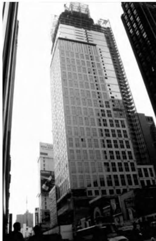
Εικόνα 3-45. Κτίριο γραφείων ιδιοκτησίας Durst Corporation με τα ενσωματωμένα φ/β πλαίσια στην πρόσοψη. [2]
