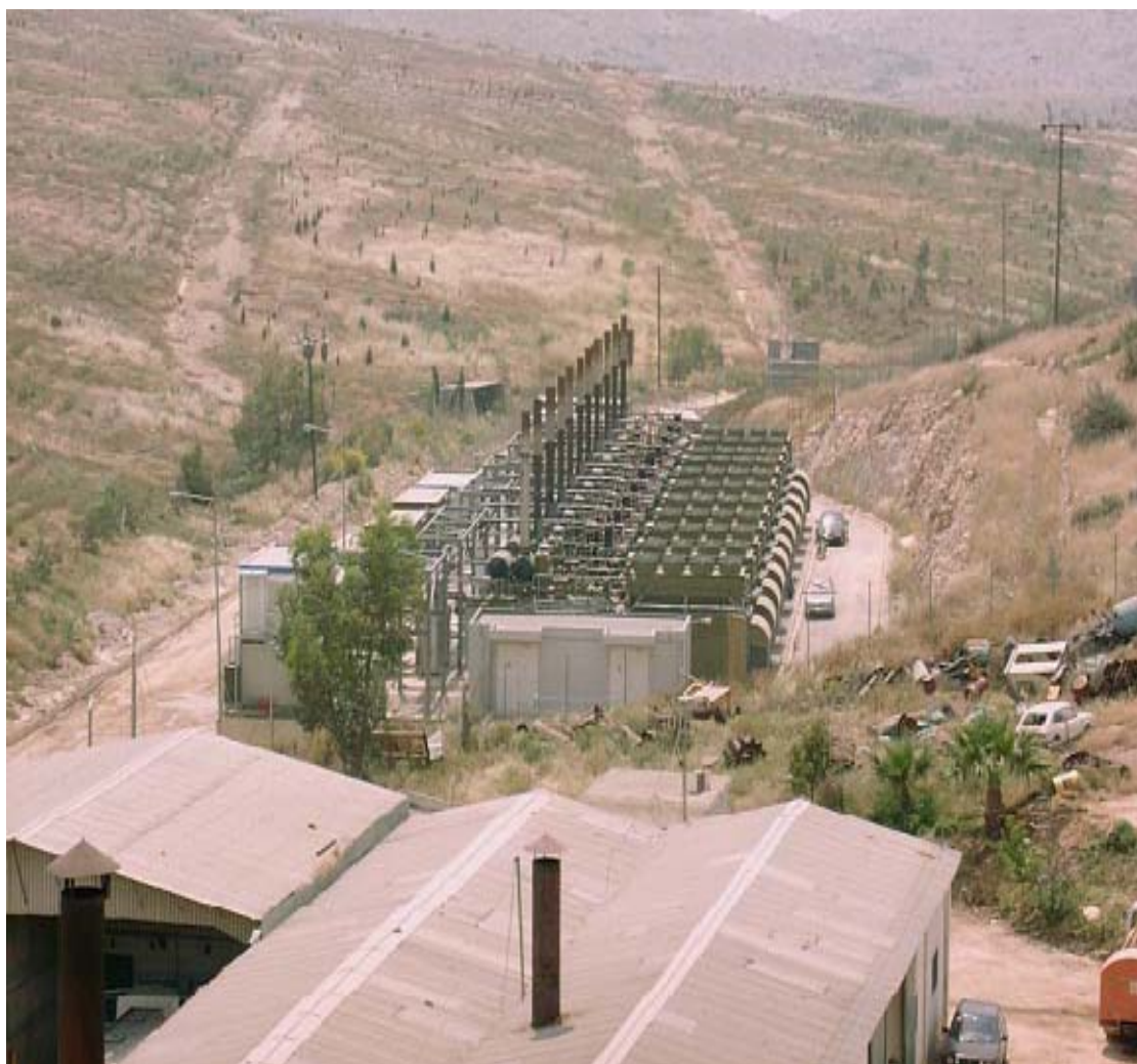
Εικόνα 2: Έργο εκμετάλλευσης του βιοαερίου στη χωματερή των Άνω Λιοσίων, Αθήνα, Ελλάδα
